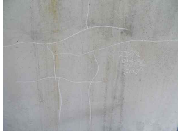
교각 P5 코핑부 망상균열(12.0×2.0)
