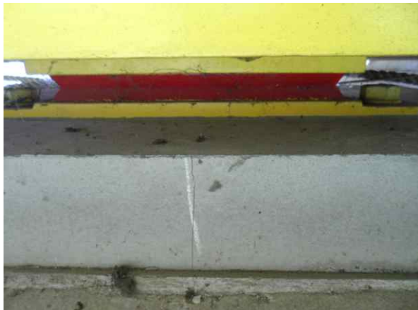
P0-Sh7 받침몰탈 균열(Cw=0.3mm미만)
